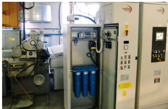
Die platzsparenden Module sind auch in bestehenden Lackieranlagen sehr einfach integrierbar und nahezu wartungsfrei.
